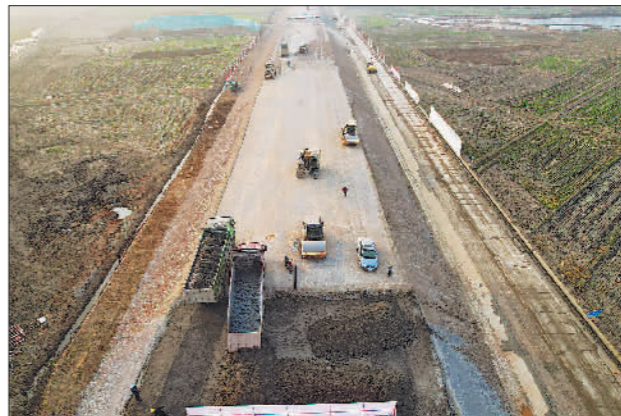
3月10日,沪渝蓉高速铁路建设传来捷报,由中铁上海局负责施工的DK104+764.46~DK104+998.3段路基工程通过国铁集团首件评估,为后续全线路基大面积施工奠定坚实基础。周虹 曹俊松 摄
