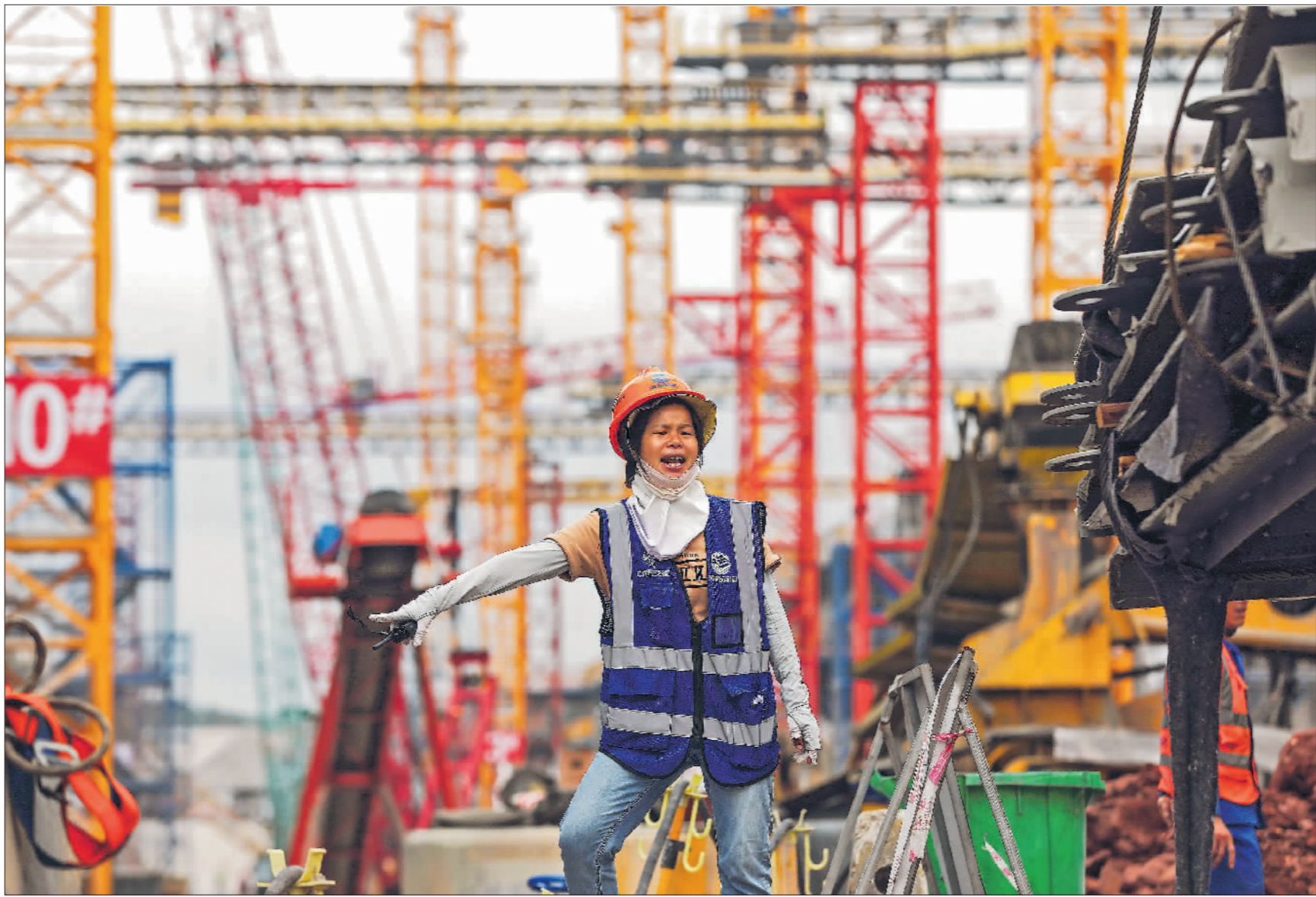
10月15日，广西壮族自治区钦州市，在平陆运河青年枢纽工程工地，来自当地的35岁司索工白焕英正在指挥塔吊进行吊装作业。
